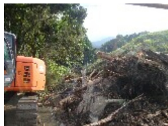
宮小路・山瀬川線流木被害
